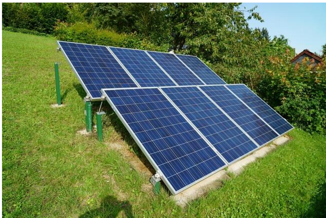
Figura 4. Paneles solares fotovoltaicos instalados en campo abierto.
