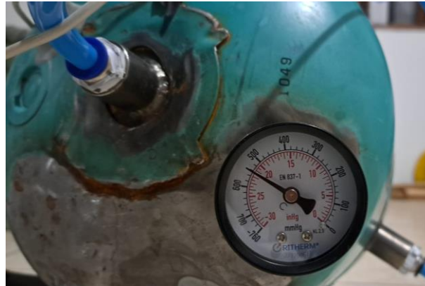
Ilustración 42. Máximo de Vacío alcanzado en el sistema.
