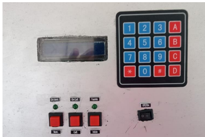
Figura 3 Tablero de control
