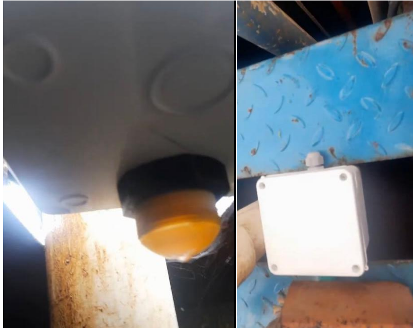
Gabinete con sensor de radar T30R y radio de comunicación inalámbrica DX80 instalados en tanque A. Fuente: elaboración propia
