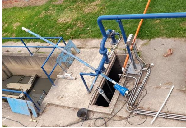
Tanque B- fuente: elaboración propia.
