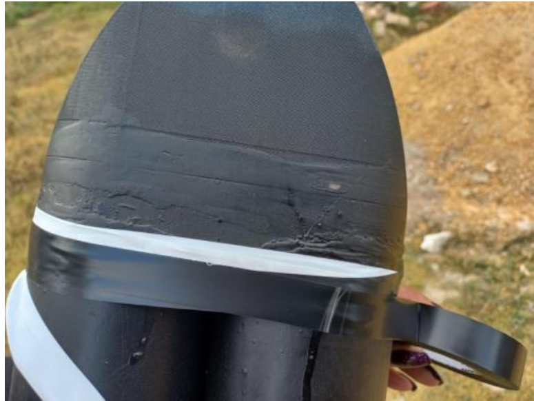
Figura 106. Corrección de filtración en casco izquierdo.
