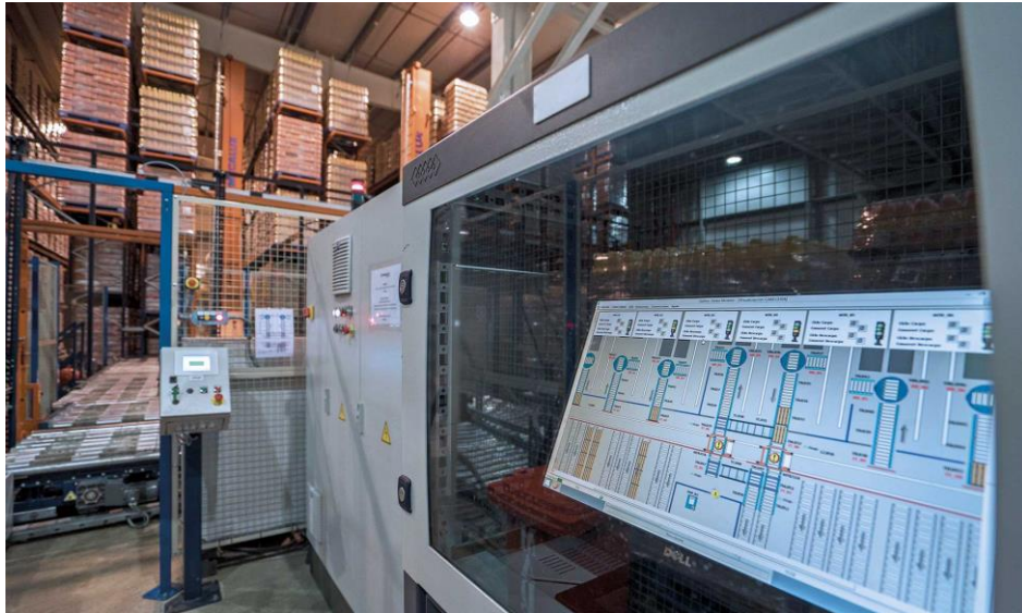
Figura 21. Ejemplo de un controlador PLC en la industria.
